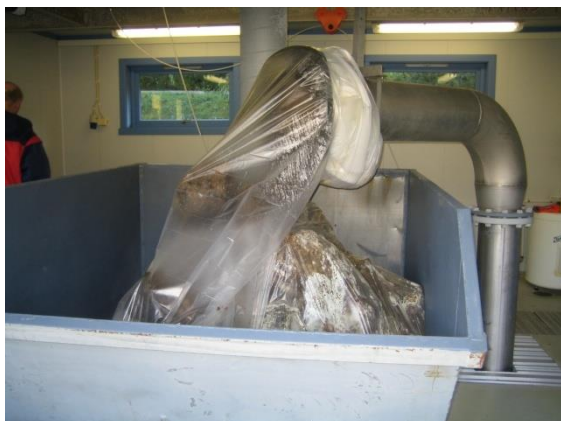
Avløpsvatnet blir reinsa gjennom ein mekanisk sil som held slam tilbake. Slammet blir frakta vekk i container.
