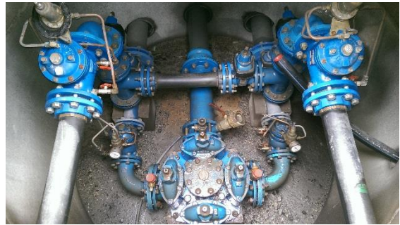
Trykkreduksjonskum ved Tyssevikvegen
