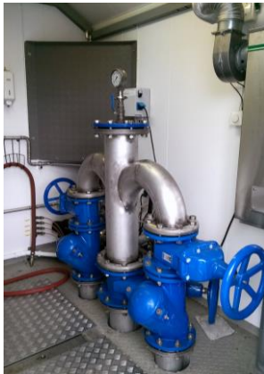
Hovudkloakkpumpestasjon sett innvendig.
