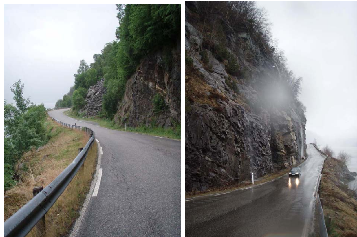
Figur 1 - Biletet til venstre viser vegen i sørenden av planområdet. Ved profil 0-70 ligg det ei bratt og mektig ur på innsida av vegen som gir minimalt med rom for utviding og utretting av kurver. Biletet til høgre viser vegen ved Torgilsberget. Skredregistret til Statens vegvesen inneheld svært mange registreringar frå dette området. Her er nedfall av stein og is frå skjeringa og i tillegg skred som kjem frå stor høgde. Høg skjering og stupbratt fjellside vidare oppover gjer at vi vurderer tunnel som den beste løysing for sikring av vegen.
