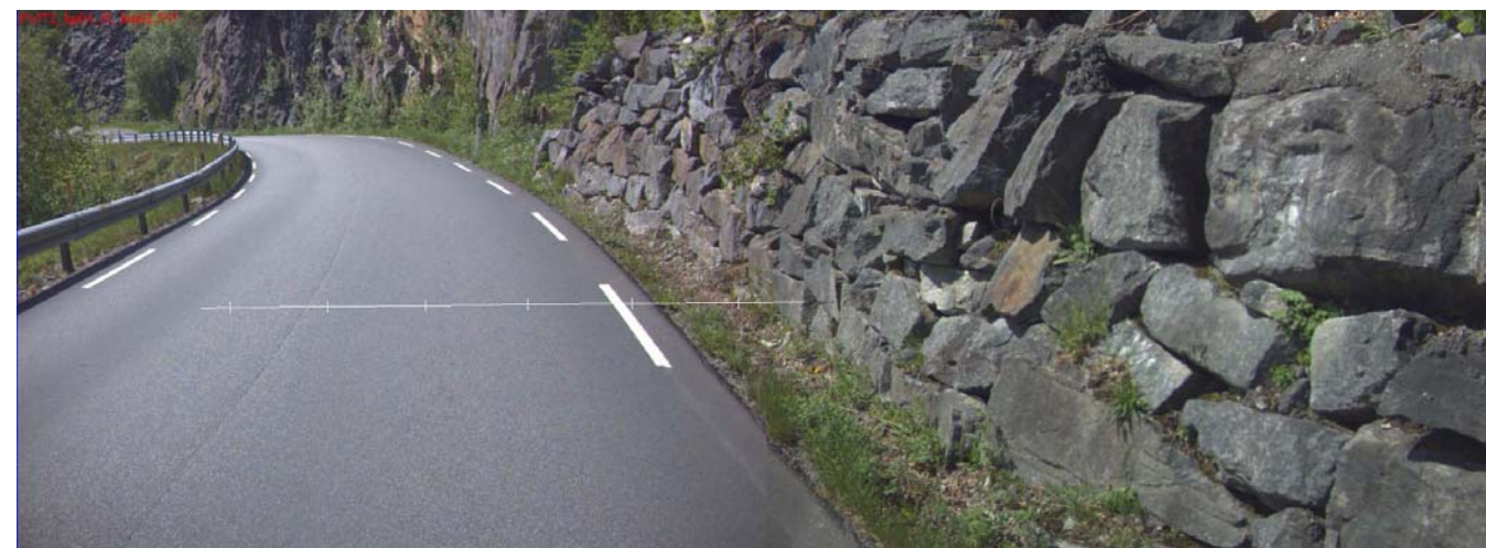
Figur 4 - Vegen ved profil 210 og sørover. Her ligg dagens veg på lausmassar. Det bratt fylling til sjøen, og på innsida er det mur mot ur og lausmassar. Det er vurdert å auke horisontalradiusen i kurva ved å bygge bru på utida, men ei risikovurdering konkluderte med at dette ikkje ville redusere risikoen. I staden er det tilrådd betre skilting og bruk av sparte midlar ved ikkje å bygge bru, til lengre tunnel som sikrar vegen mot skred ved Atlåsbekken.
