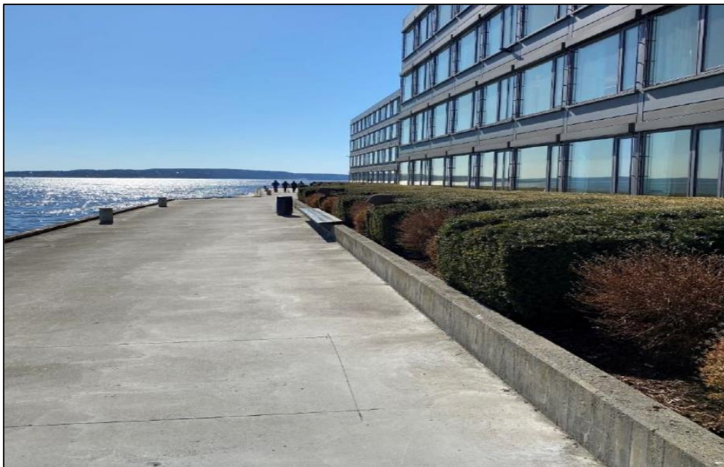
Figur 8-8 Eksempel fra Lysaker hvordan en gjennomgående betongmur kan kamoufleres som en blomsterkasse. Jorda vil fungere som et regnbed som hindrer vannet i å sige inn i bygget. Ved høy bølgepågang vil plantene bli skadet. Foto: Norconsult
