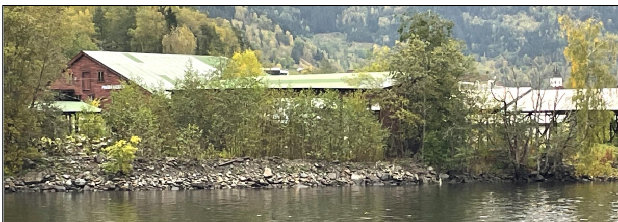
Figur 6-2 Stranda sør for Storøy/Pallefabrikken er fylling utan plastring/sikringstiltak.
