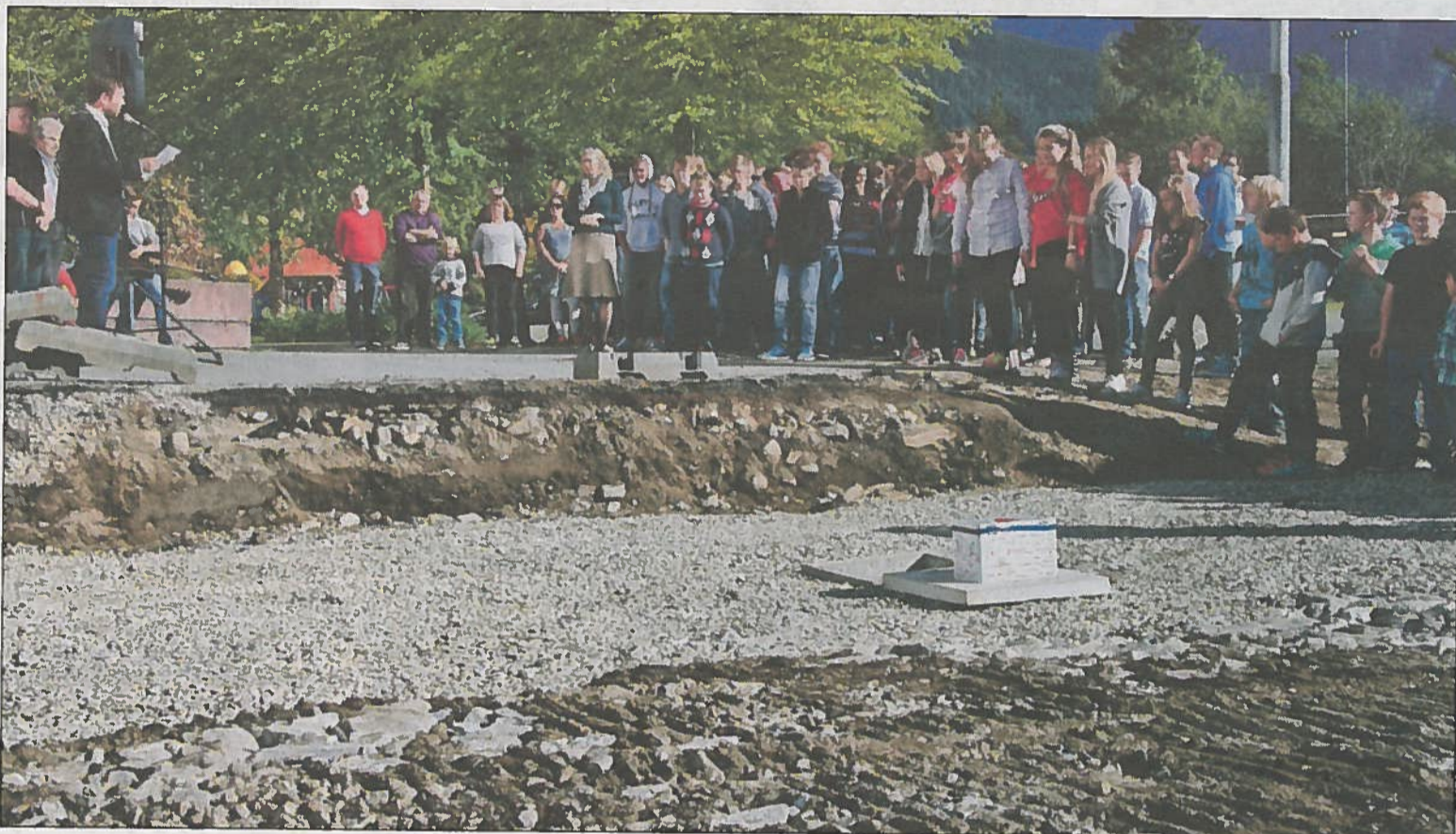
I GANG: Fleirbrukshall har vore snakka om lenge i Ulvik. Tysdag hadde ein seremoni med ordførartale og grunnsteinsnedlegging for å markera byggjastart.
